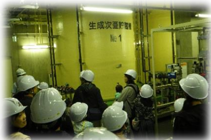
地下探検 薬注設備の説明
