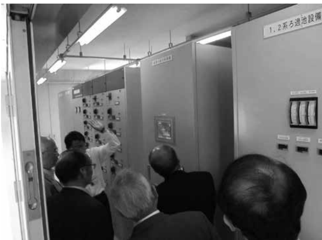
施設見学(浄水機器設備の説明)
