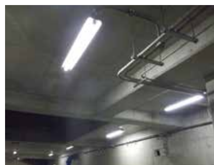
すりかみ浄水場内のLED電灯
