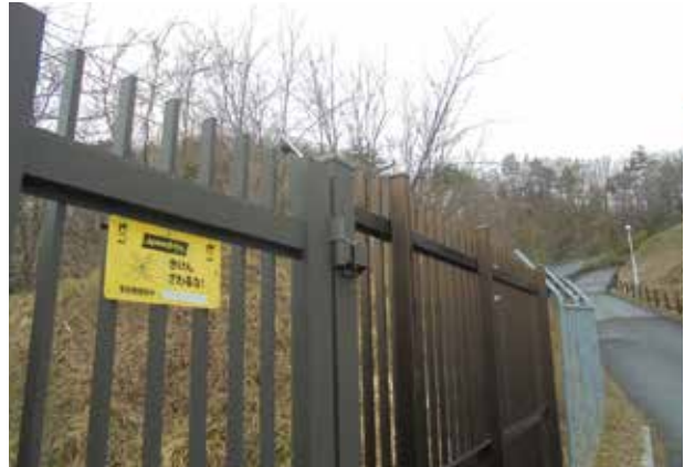
すりかみ浄水場電気柵
