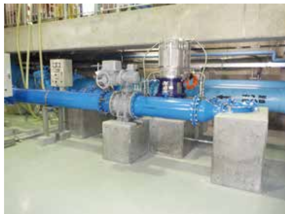
福島増圧ポンプ所小水力発電設備
