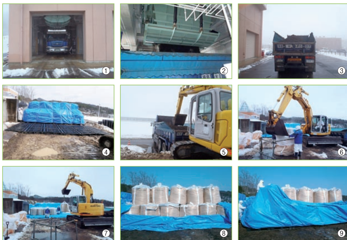
① 脱水機棟へのトラック（10t）入庫 ② 浄水ケーキ積載 ③ 運搬 ④ パレット設置 ⑤ 浄水ケーキ積降 ⑥ 浄水ケーキ袋詰 ⑦ 積上状況 ⑧ 積上完了 ⑨ シート養生
