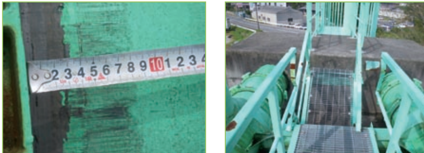
伏黒水管橋の伸縮管移動状況及び脱落した歩廊
