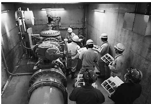
応急給水支援設備操作説明状況
