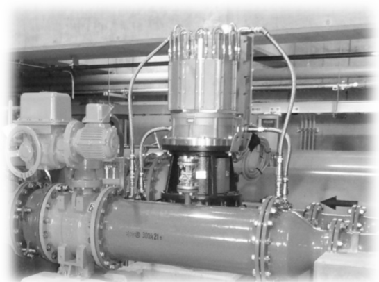
縦型インラインポンプ逆転水車
