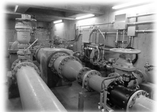
縦型インラインポンプ逆転水車
