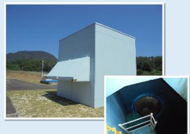
9 後塩素混和池
